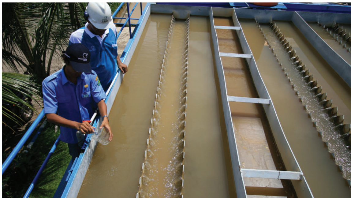
Pengolahan Air Bersih - PT Medco E&P Indonesia
